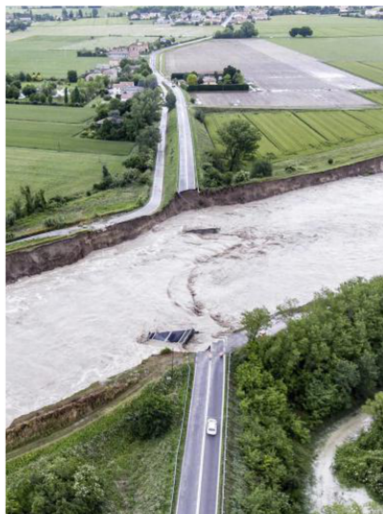
CROLLATO Il ponte della Motta che collegava Budrio con San Martino in Argine nella bassa bolognese: spazzato via dalla furia dell'acqua
